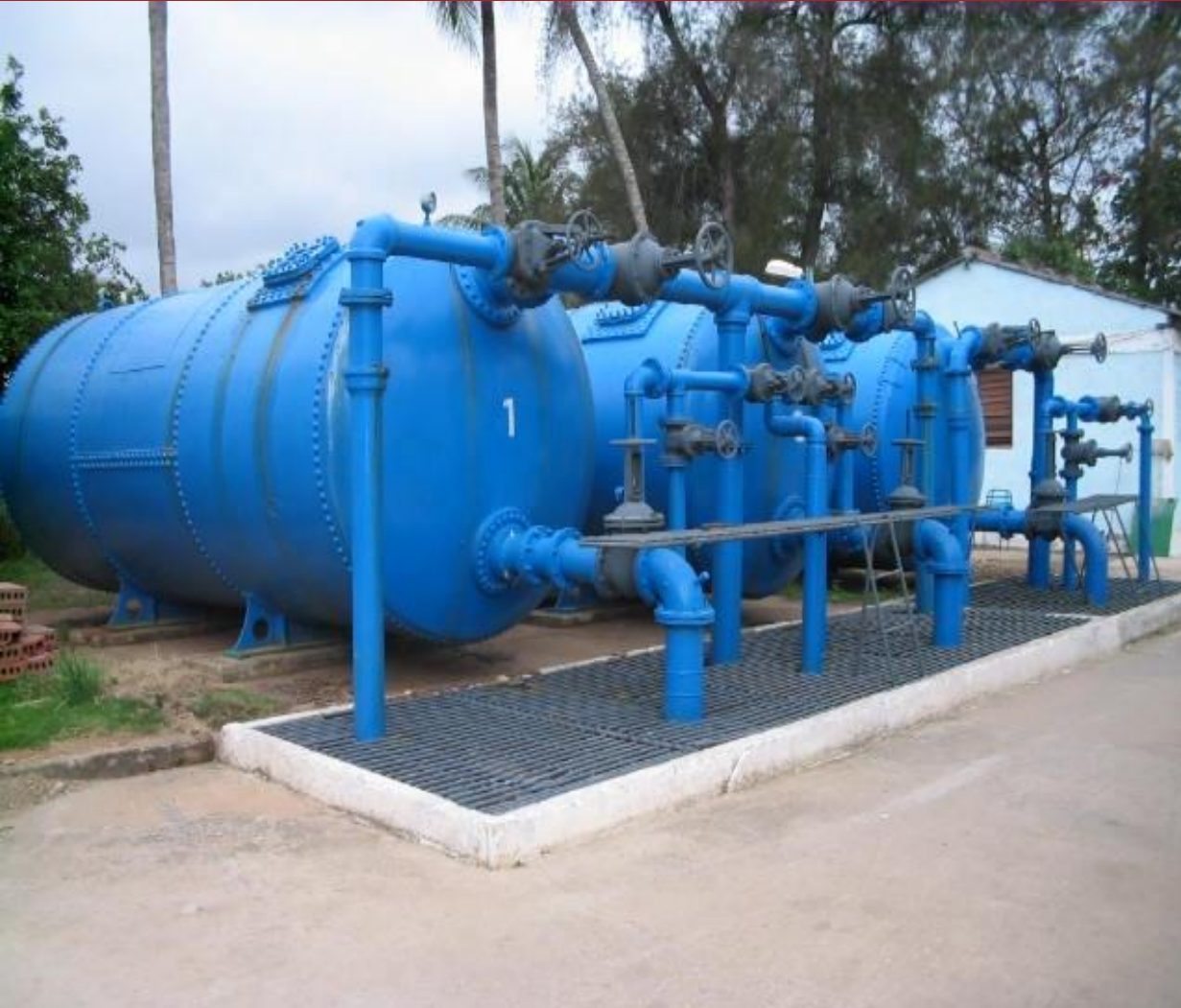
تصفیه خانه های آب - کوبا
